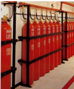
IMPIANTI A GAS INERTI
